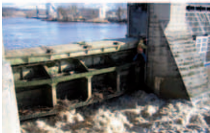
Bild 4: Zwischen Pfeiler und Wehrverschluss eingeklemmter Baumstamm (oben), Entfernen eines Baumstamms aus der Pfeilernische (unten)
